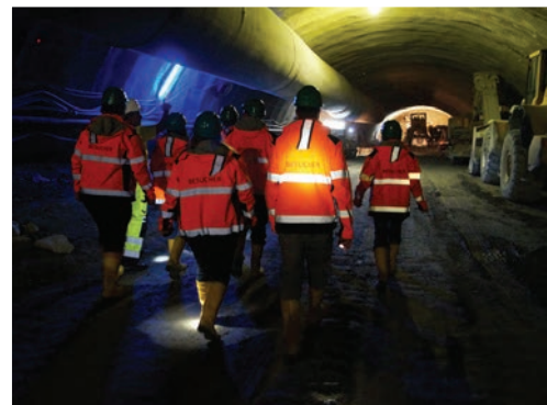
Vier Kilometer tief im Berg: In knapp 10 Jahren soll der Brenner-Basis-Tunnel fertiggestellt sein.
