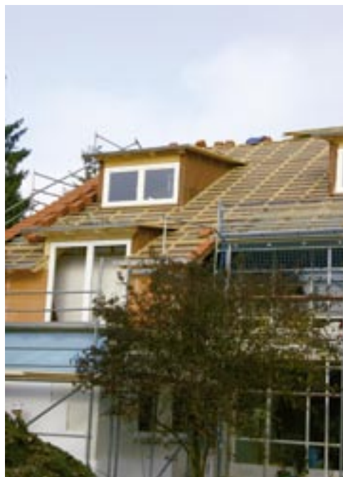
Ein neues Dach für das Haus des Pflugs - das Wetter spielte glücklicherweise mit
